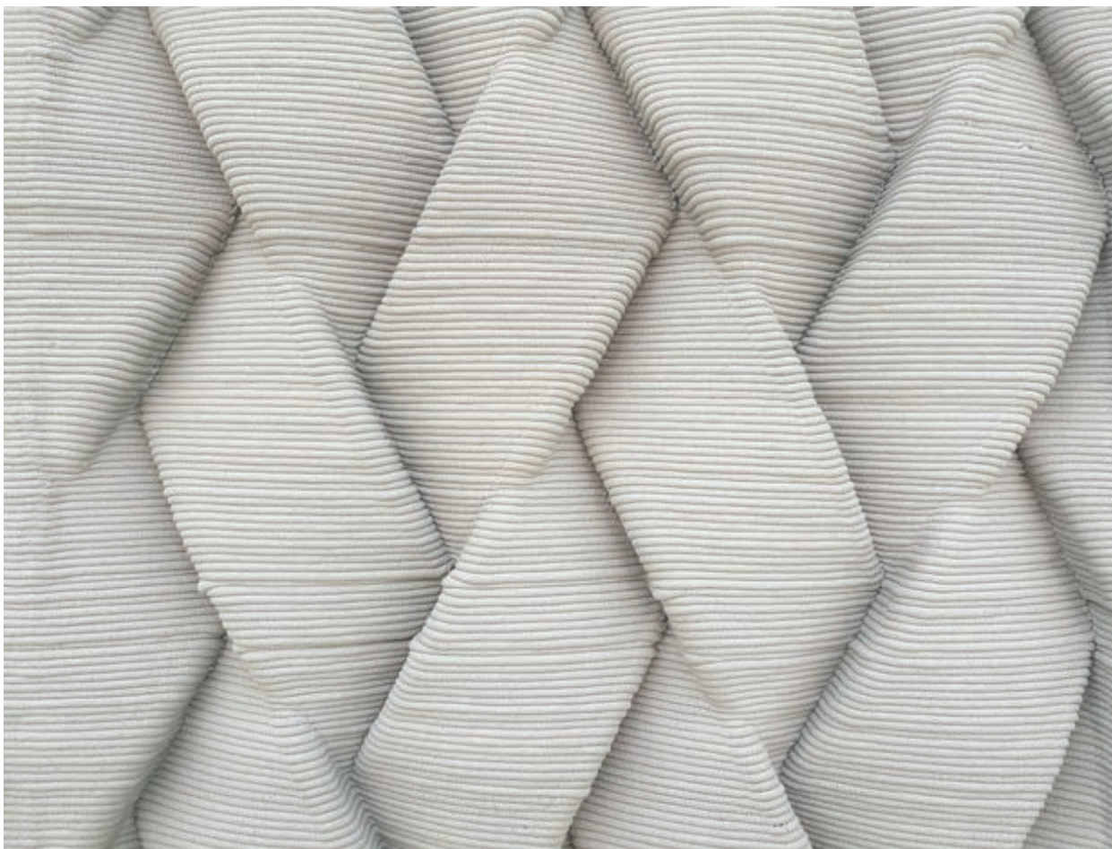
RYSUNEK 3.17. Przykład nietypowej betonowej ściany budynku mieszkalnego, wzniesionej przy użyciu drukarki 3D
